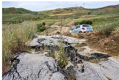
In der Gegend von Portella Incantena ist die Strasse 100 Meter abgerutscht.
